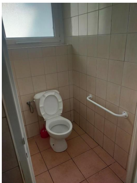
Zdjęcie nr 13: Toaleta w budynku I
